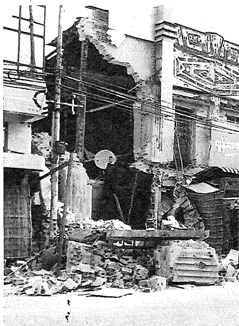
地震で崩れ落ちた建物＝1日、ミャンマーのザガイン地域で（地元住民提供）
